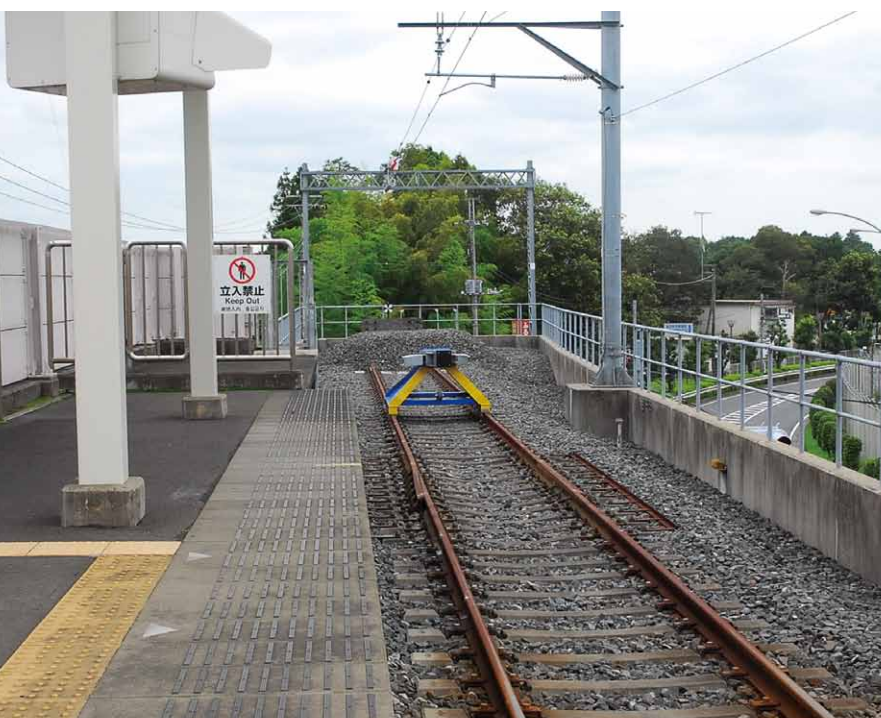
▲途切れたままの線路
