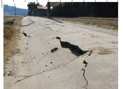
東日本大震災による道路の被害(平成23年)
