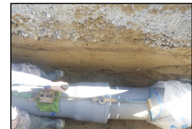
※管種：ダクタイル鋳鉄管
