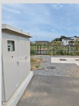
▲整備された浄化槽
