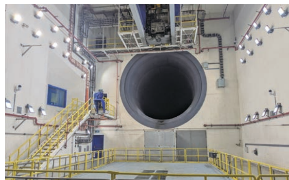
▲ロールスロイス社の大型エンジン用テストセル。最先端の防音設備で道路を挟んだ反対側には高層住宅が並ぶ。
