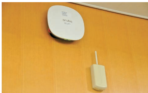
▲南庁舎内 Wi-Fi 機器
