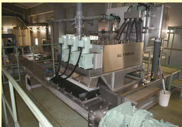
▲老朽化した汚泥脱水機
