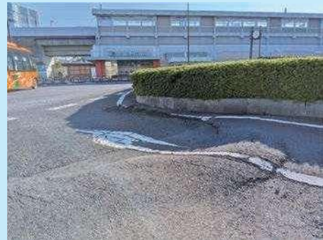
▲ロータリー各所に路面の歪み
